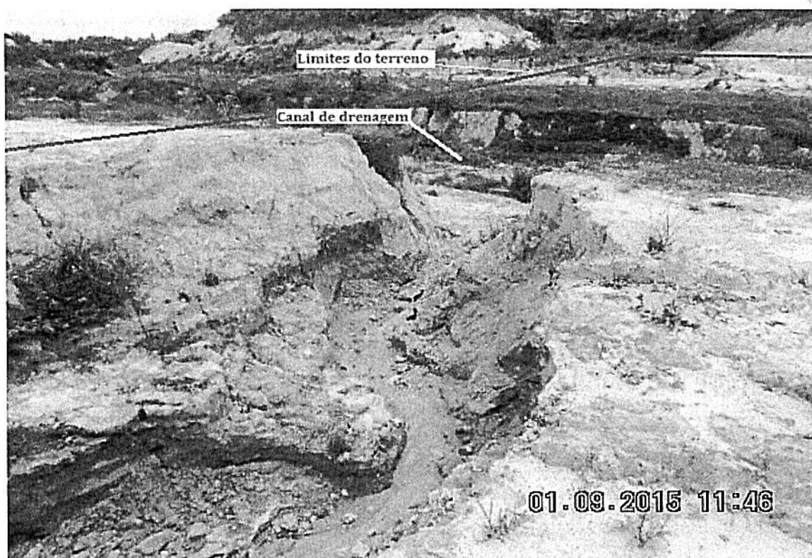
Foto 26: Condição do Terreno 6 após período de chuva
