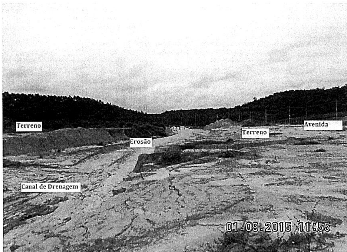
Foto 28: Condição do Terreno 6 após período de chuva
