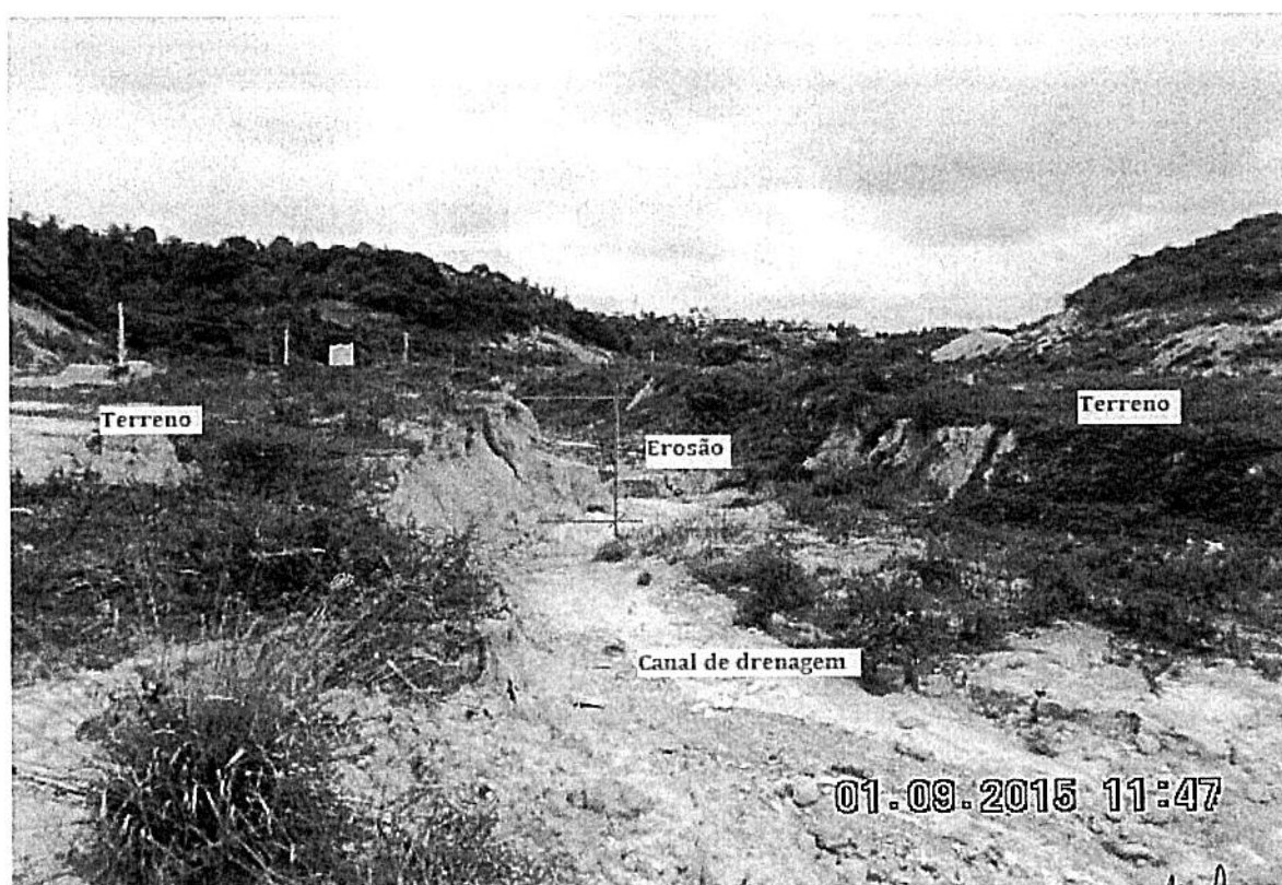
Foto 27: Condição do Terreno 6 após período de chuva
